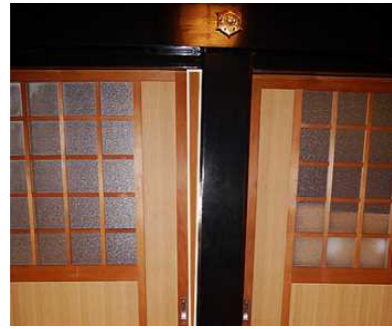
1-①-イ 柱が傾いて、襖や戸との間に隙間ができています。
