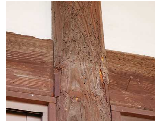
1-③-イ 腐朽が進む本堂柱
